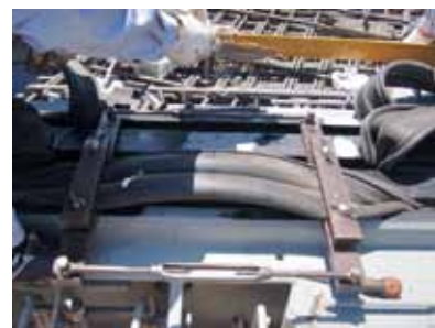
加硫接続後の水密性についても確保されていることを確認しております。
